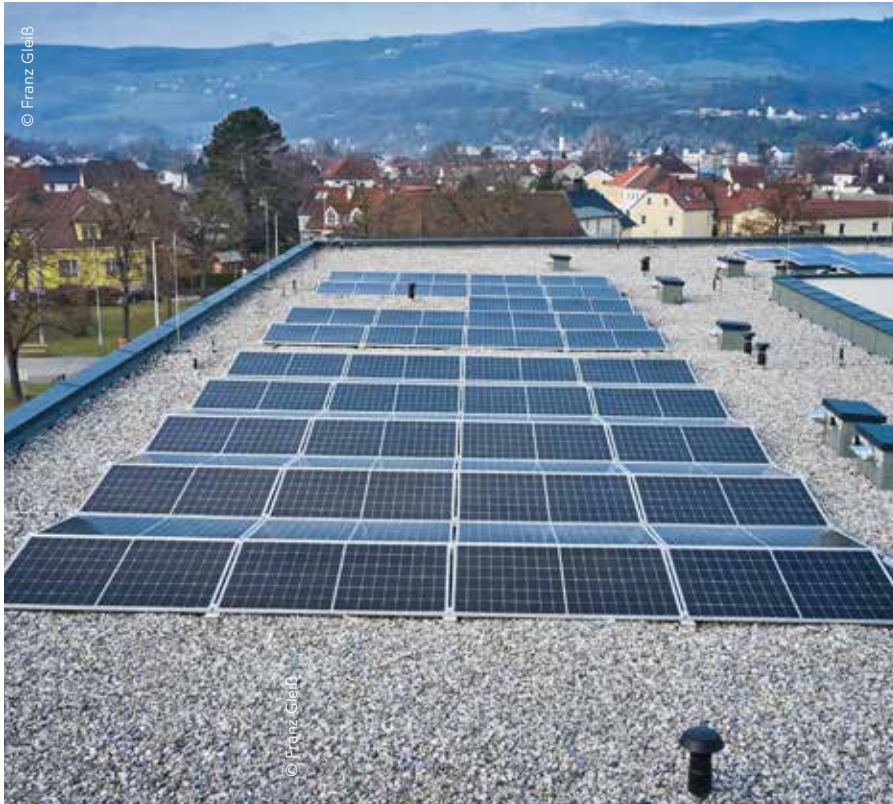
Auch am Flachdach des neuen Ortszentrums ist eine Photovoltaik-Anlage mit einer Gesamtleistung von 30 kWp installiert. Informationen zu den Photovoltaik-Anlagen in der Gemeinde gibt es am Samstag, 25. März, von 8 bis 13 Uhr.
